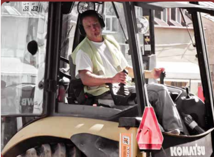
Pozorný Henrich pri výkopových prácach na stavbe v Michalovciach, kde sa revitalizuje centrálna mestská zóna.
