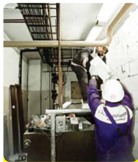
Chlapi majú sťažené podmienky pri práci, keďže v kotolni sa musí stále kúriť. Na foto: Lukáš Dzvoniak a Vladimír Ferenčík.
